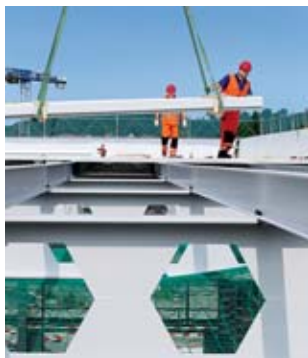
Regola 8 Per i lavori in quota usare una protezione collettiva.
