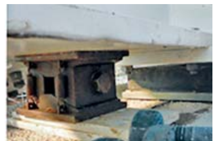
3 Cautela in presenza di appoggi temporanei: evitare il ribaltamento di travi!
