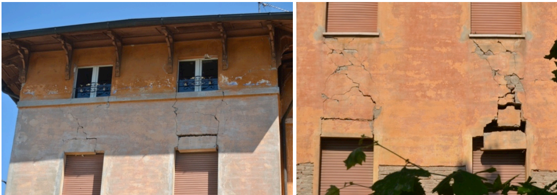
Fig. B-2 Danno nelle fasce di piano, con attivazione di meccanismi sia di pressoflessione che taglio.
