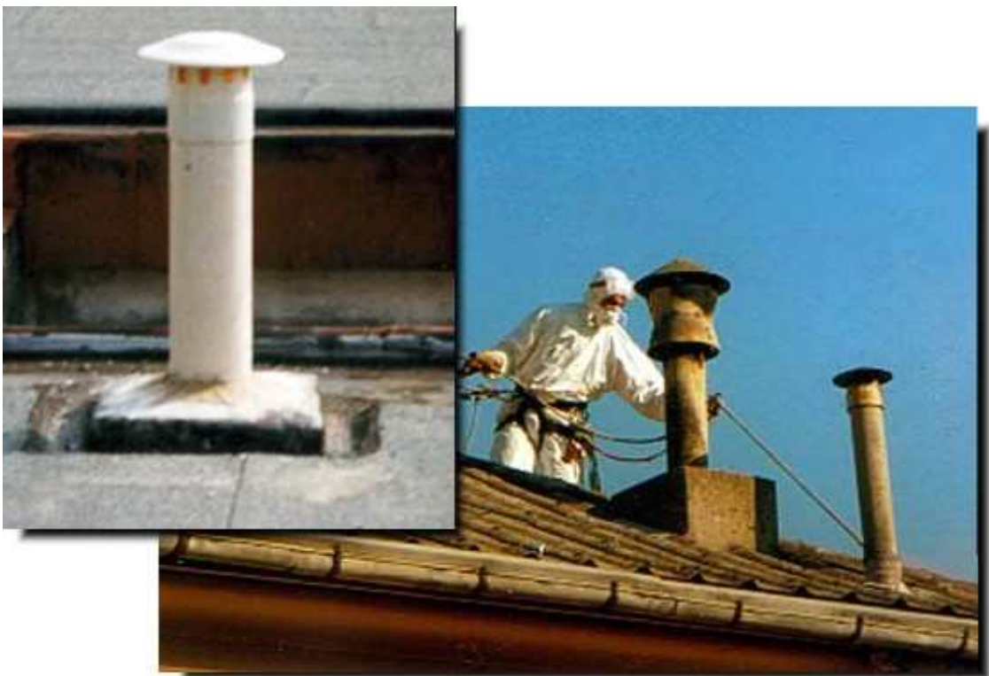
Figura 42 - Manutenzione di canna fumaria
