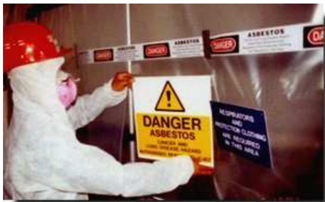
Figura 52 - Affissione della segnaletica di sicurezza
