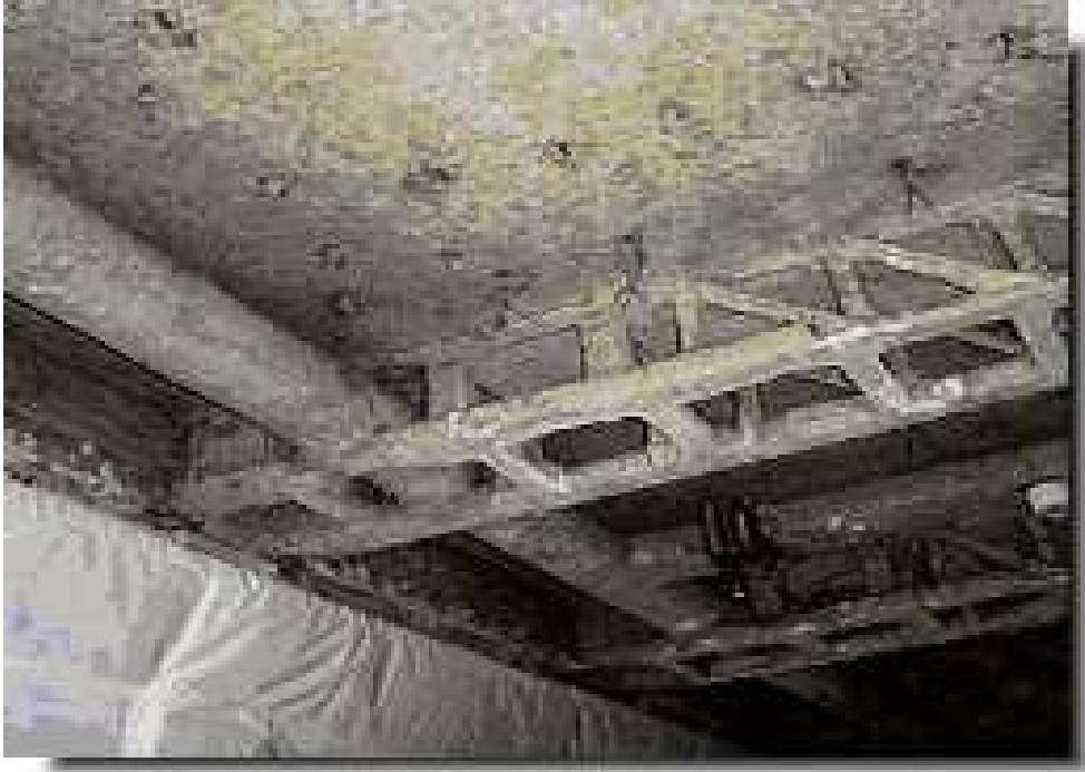
Figura 11 - Amianto friabile spruzzato nelle strutture metalliche di un edificio
