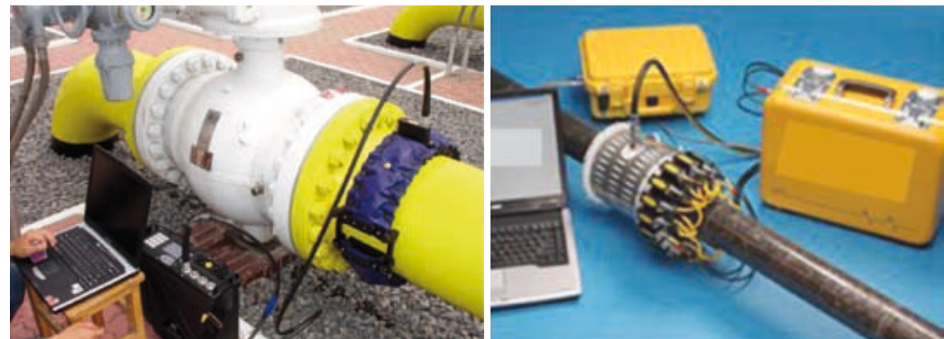
Fig. 8 - Vista di alcuni tipici apparati strumentali per il controllo ad OG, costituiti dal sistema di generazione/ricezione (installato sulla tubazione) e dalla relativa unità di controllo.
