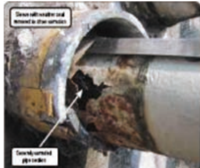
Fig. D9 - Stato della tubazione in penetrazione in parete "in camicia" dopo la rimozione della guarnizione anti-intemperie.
