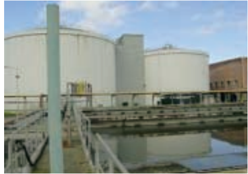
Vista Digestori Fanghi/Gazometri
