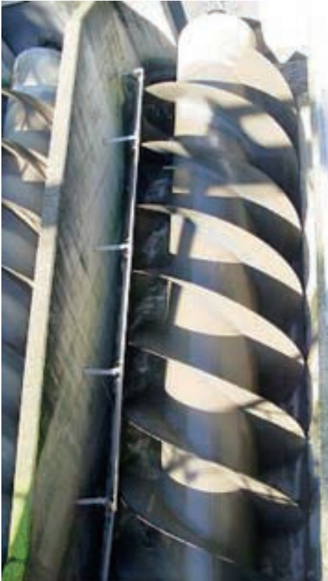
Coclea di sollevamento liquami
