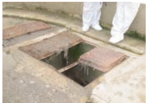
Pozzetto di campionamento (notare la copertura fatiscente)
