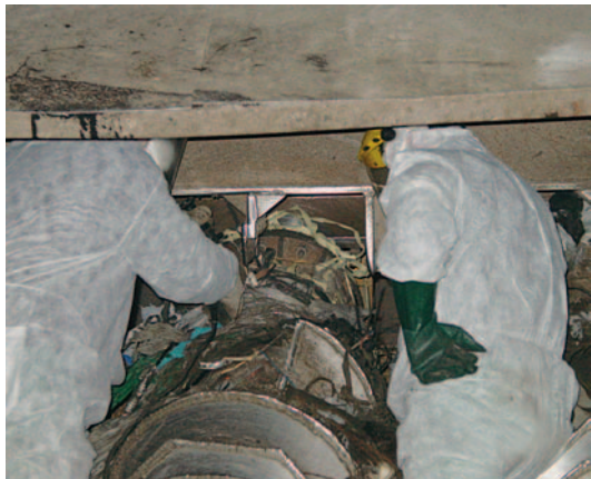
Operazioni di pulizia all'interno del trituratore
