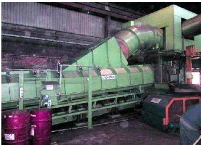
Foto 21 - Linea di sterratura segregata presidiata da aspirazione localizzata.
