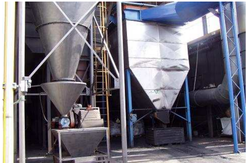
Foto 2 - Sistema di depolverazione con ciclone separatore su scarico silos stoccaggio sabbie.
