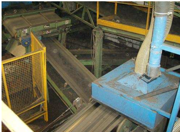
Foto 5 – Impianto di recupero terre a verde – vista cappa di aspirazione di "cadute" nastri
