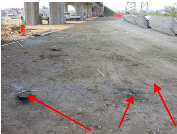
Figura 7. Luogo dell'incidente: impronte del camion e impronta dello stabilizzatore dell'autogru
