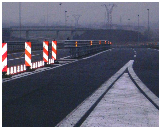
Dicembre 2004 IR 63 – Rampa sud sovrappasso svincolo Chivasso est con rotonda. Opera completata
