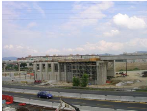
Luglio 2004 GA 01 – Galleria artificiale. Svincolo Settimo uscita da Torino. Casseratura soletta di copertura
