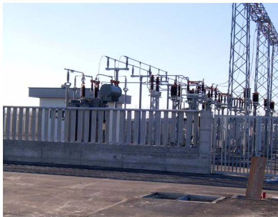
Dicembre 2004 FA 17 – Fabbricato posto di parallelo doppio Novara ovest. Lavori di montaggio tralicci
