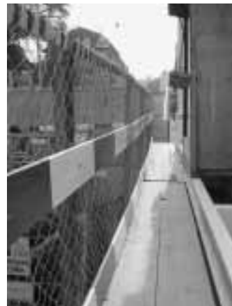
Fig. 1: è molto importante che i pozzetti iniziali e finali abbiano dispositivi anticaduta e accessi sicuri.
