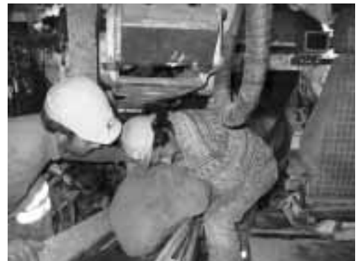
Fig. 5: durante i lavori di avanzamento il personale deve essere sempre attento e pronto ad intervenire anche in caso di situazioni impreviste.
