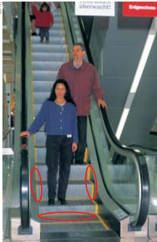
❷ Scala mobile con punti di schiacciamento contrassegnati convenientemente.
