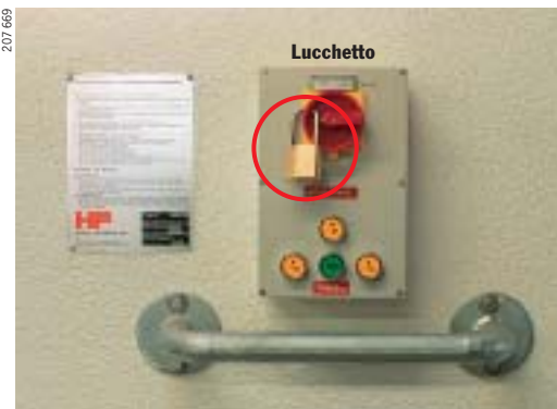
④ Interruttore di sicurezza all'interno dell'edificio.
