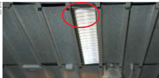
3 Elemento del soffitto instabile – una potenziale fonte di pericolo.
