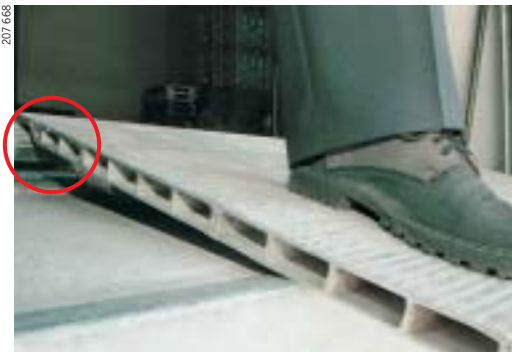
③ Passerella mobile di carico ancorata malamente: un'evidente fonte di pericolo.
