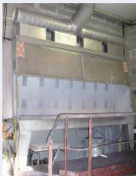
Poste de lavage n° 1.
