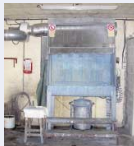
Poste de lavage n° 2.
