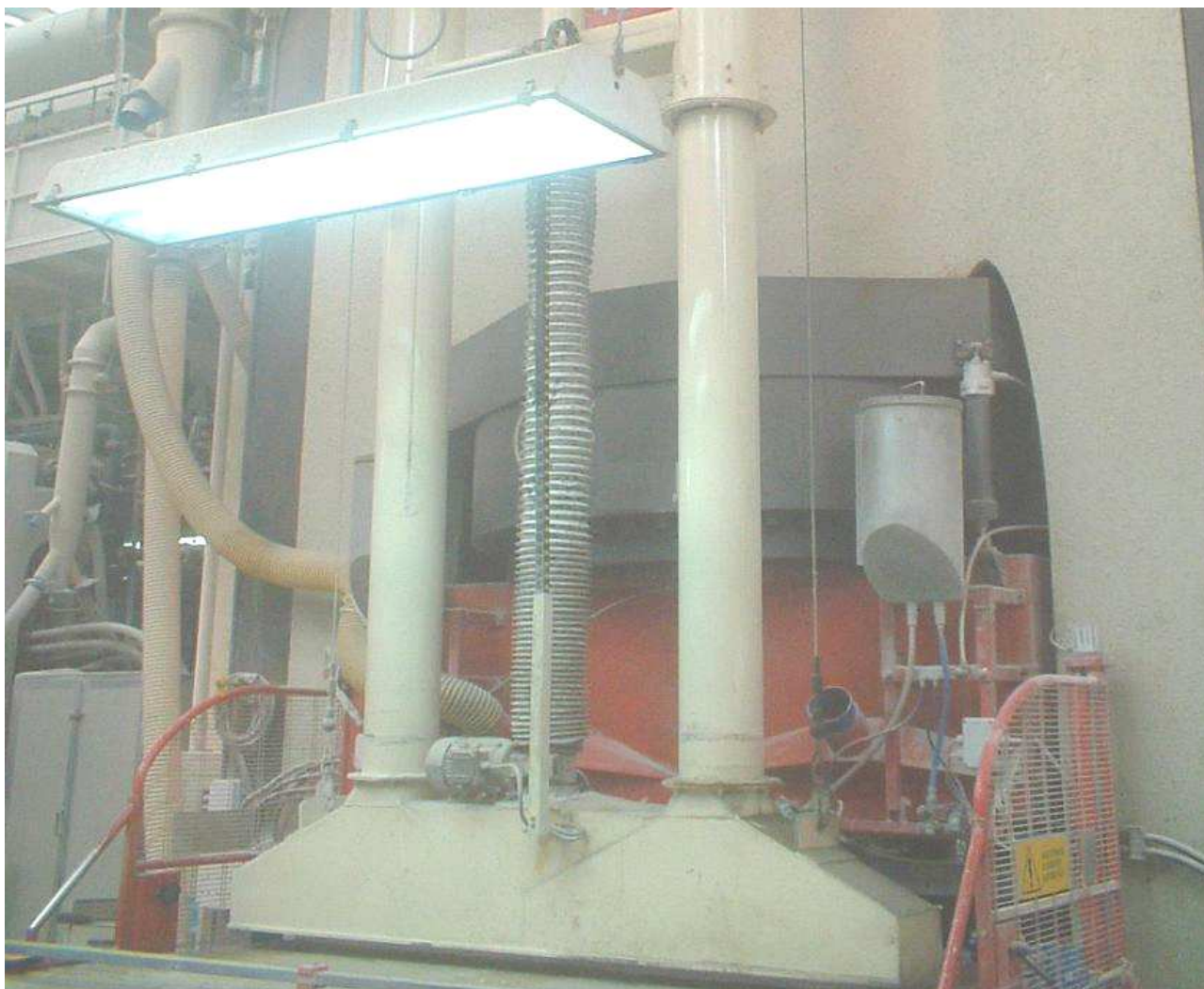
Cappa mobile uscita pressa, con tubazioni aspirazione telescopica.
