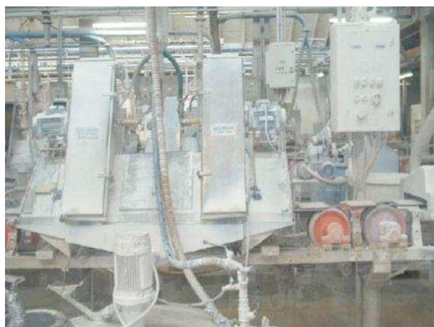
Applicazione di engobbia in capanno aspirato: con sistema a dischi
