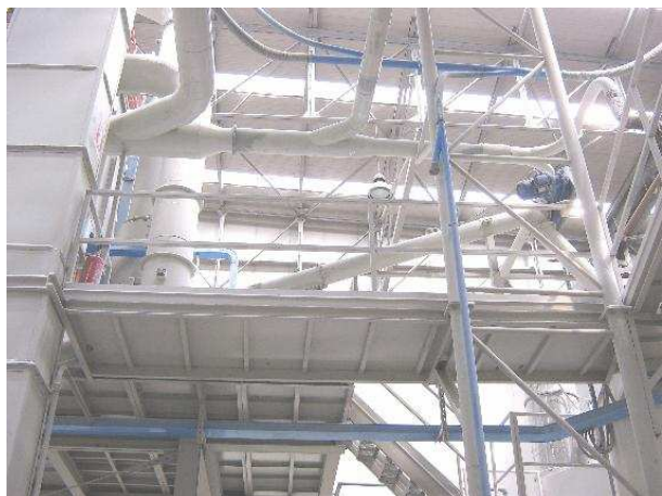
Sopra: Elevatore per il rifornimento delle tramogge.
