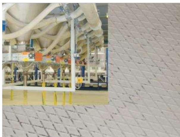
Pavimento di stazione preparazione polveri pulito a secco (in alto a sx. le attrezzature al piano).
