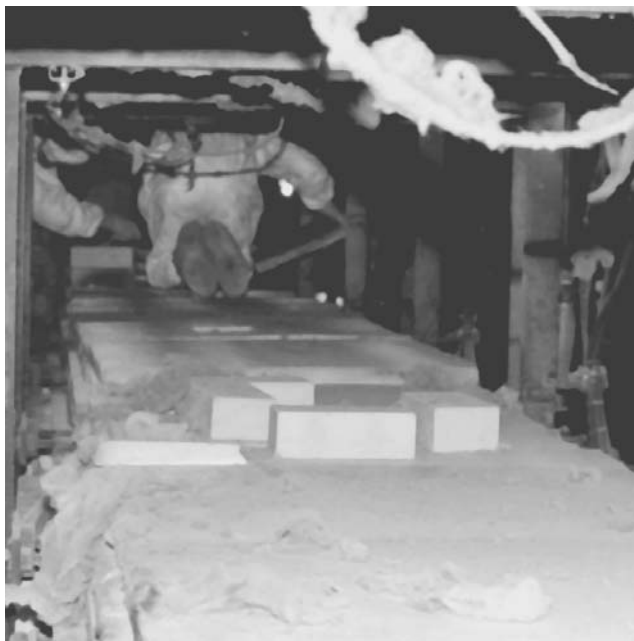
Figure 84.4 • Travail en espace confiné lors de la réfection d'un four dans une usine de fibres de verre
